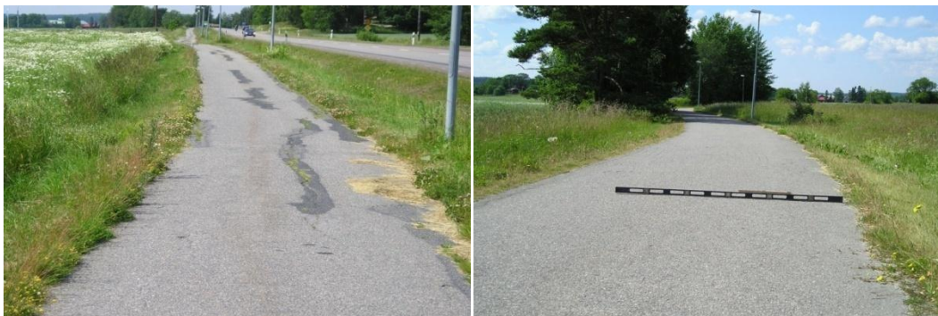
Figur 6 t.v. GC-väg Bergshammar anlagd 1985. Byggd med naturgrus i väggroppen. Sträckningen uppvisar stora skador av flera olika typer och är i akut behov av åtgärd.
